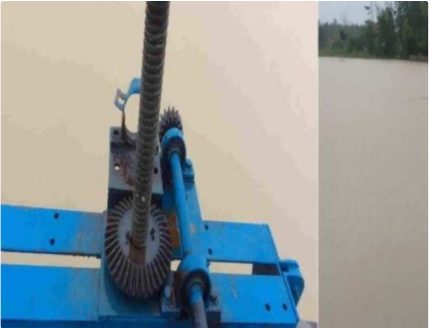
Pintu air Albaret Simpang Mesuji
